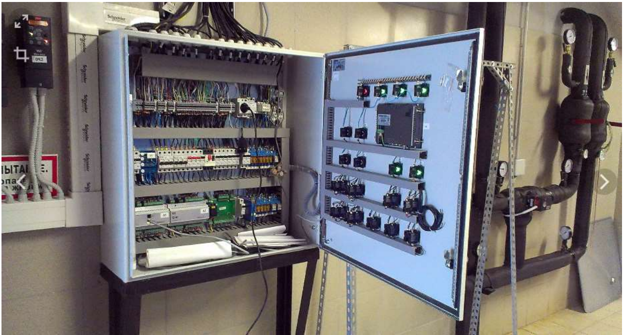
Рис. Электрический шкаф с аппаратурой автоматизации
